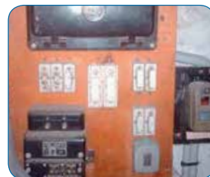
Support de compteur électrique en amiante-ciment
