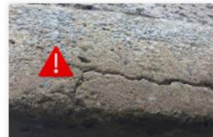
Détecter automatiquement des défauts dans le béton grâce à l'intelligence artificielle
